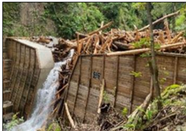
治山ダムに異常堆積した土砂や流木
