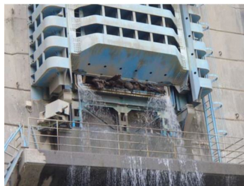
図1 閉塞した裾花ダムのコンジットゲート
