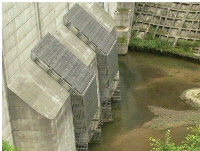
益田川ダムの穴の上流側に設置されたスクリーン
