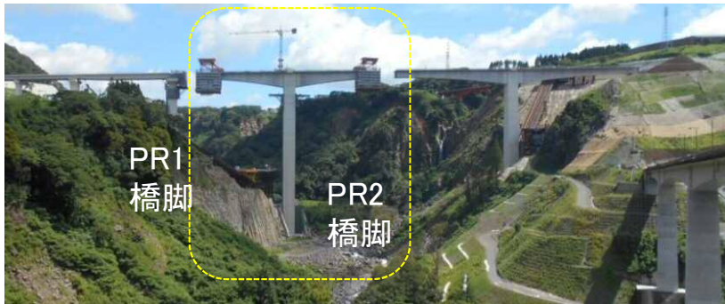
橋桁をのばした先端部が支えられていない状態でも橋桁が落ちない構造の新阿蘇大橋(建設中の様子)
