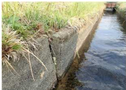
水路壁の傾き
