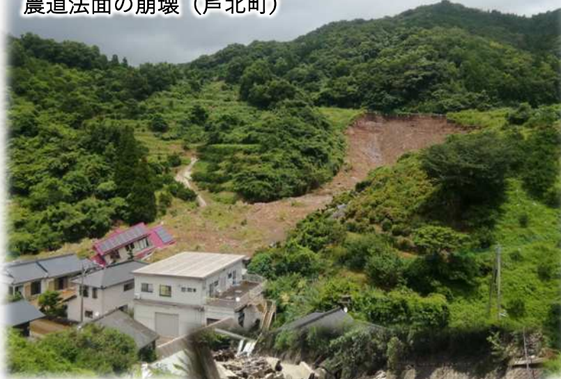
農道法面の崩壊（芦北町）
