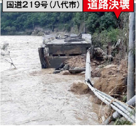
国道219号(八代市) 道路決壊
