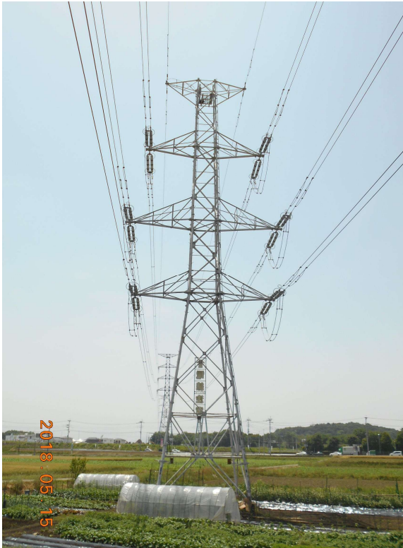
22万ボルト送電線
