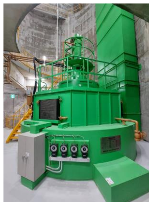
第二発電所発電機（リニューアル後）
