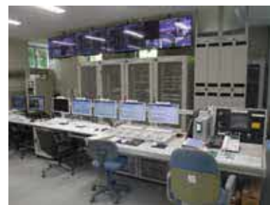
ダム管理用制御処理設備
