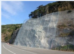
国道389号落石防護網（天草市）
