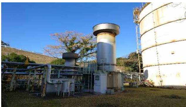
余剰ガス燃焼装置
