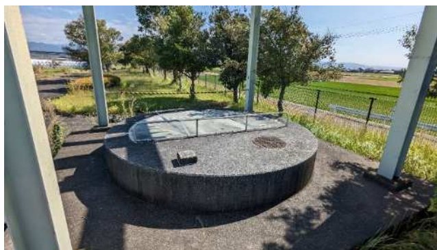
マンホールポンプピット
