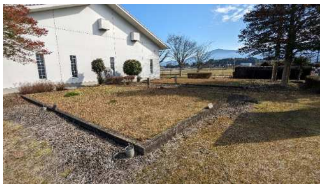
汚泥脱臭床 (ポンプ棟横)
