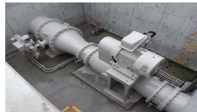
小水力発電設備
