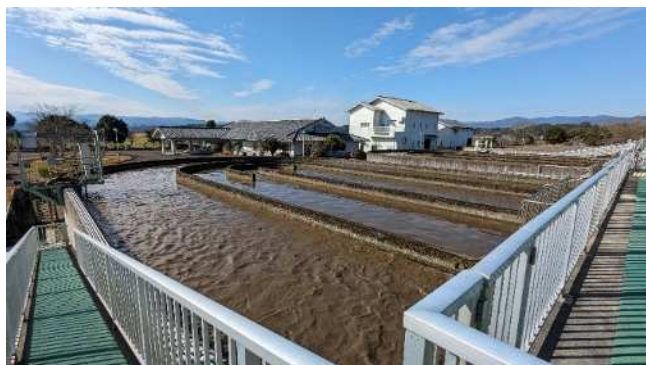
オキシデーションディッチ (OD槽)
