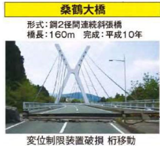
図 3-23 道路の被災リスク（落橋・橋梁の破損：平成 28 年熊本地震による被害）
