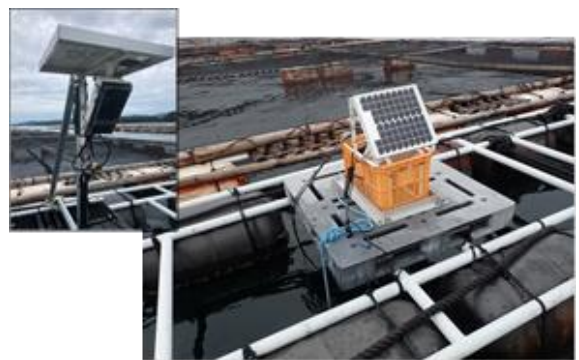
図1 水質監視テレメータシステム(テレメータ)
