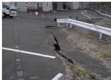
(b)のり肩の亀裂
