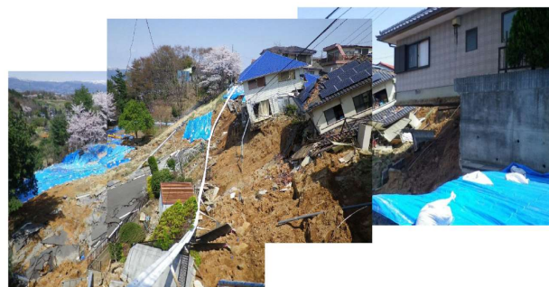
(d)液状化による側方流動
