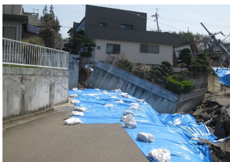
(c)腹付け盛土の崩壊
