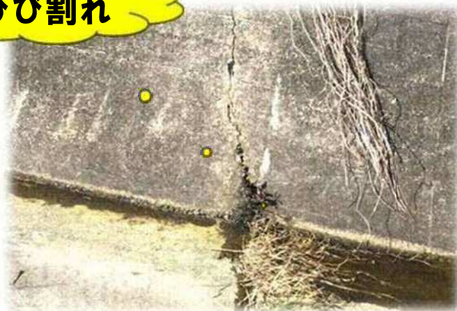
ひび割れから湧水
