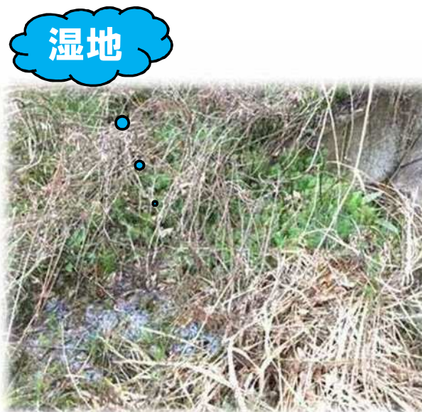
下流地盤面の湿地状況
