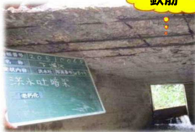
鉄筋のむき出し
