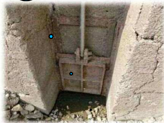
ゲート周りに漏水
