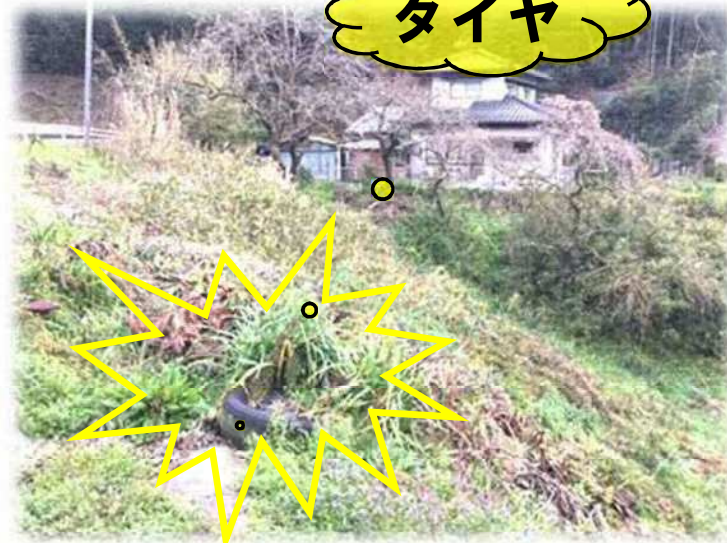
堤体に古タイヤの放置
