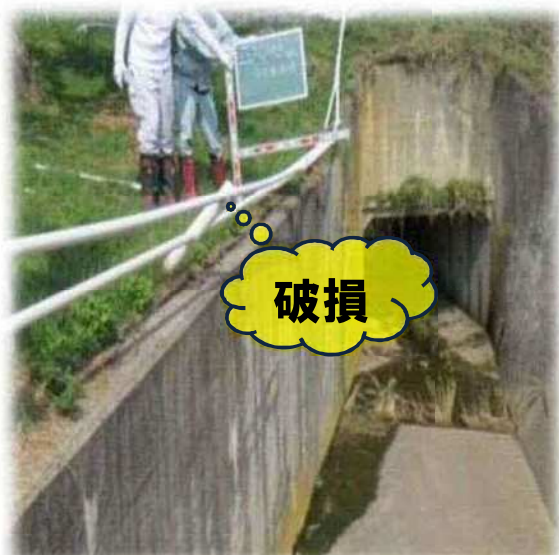
転落防止柵の破損
