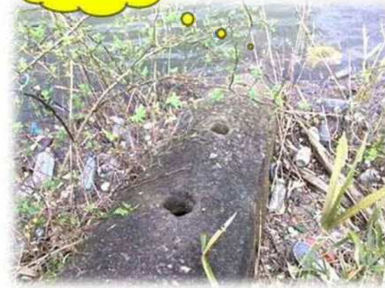
斜樋取水孔回りにゴミ
