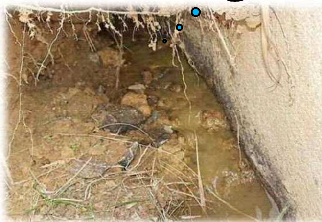
洪水吐と境界部陥没
