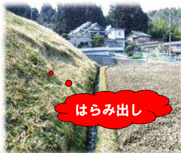
堤体のり面のはらみ出し
