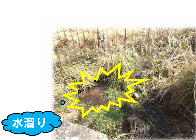
下流地盤面に水溜り
