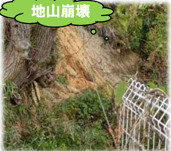
ため池周囲 土砂崩壊
