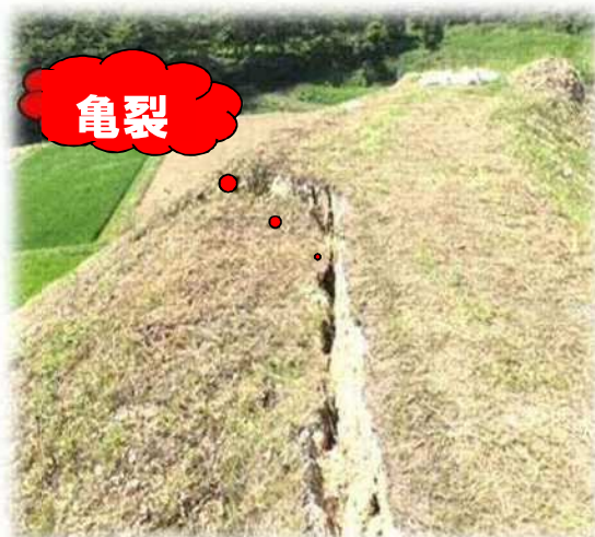
堤体の頂部亀裂
