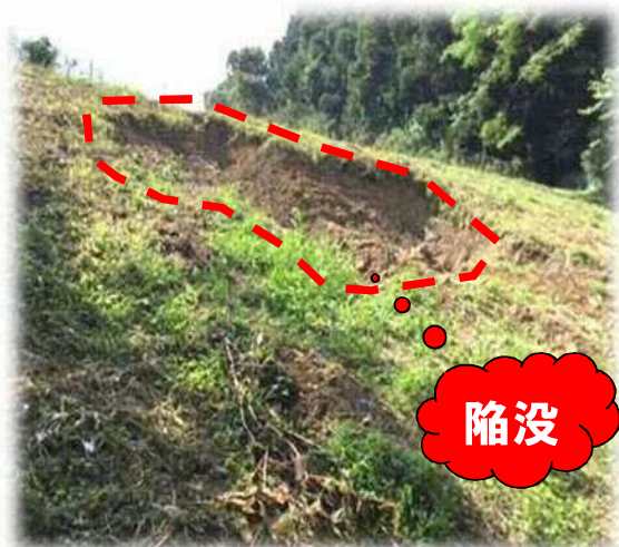
堤体法面の滑落
