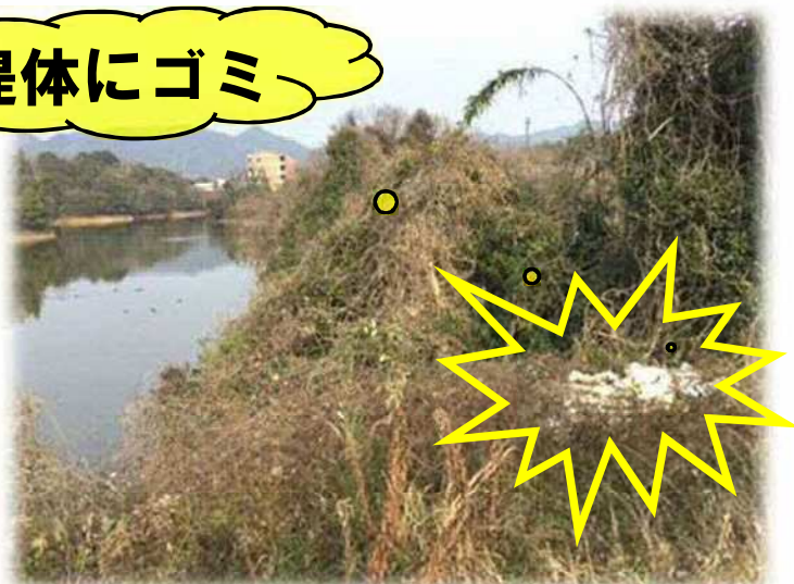
堤体にゴミ等が散乱
