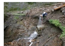
⑩保安林管理道の崩壊(八代市)
