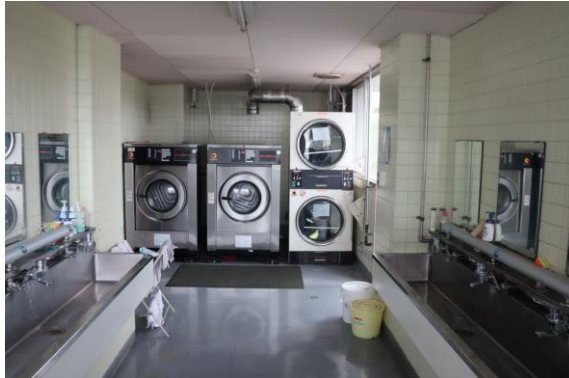
寄宿舎2～3階の洗濯室に設置している業務用の洗濯機・乾燥機
