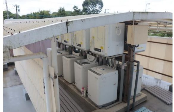
ベランダに設置されている家庭用の洗濯機・乾燥機
