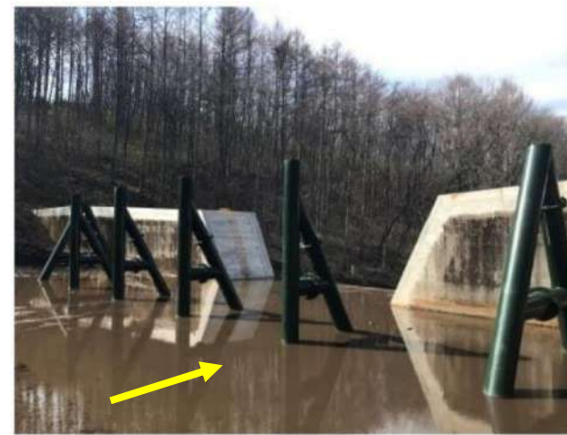
鋼製スリット堰堤 A 型
