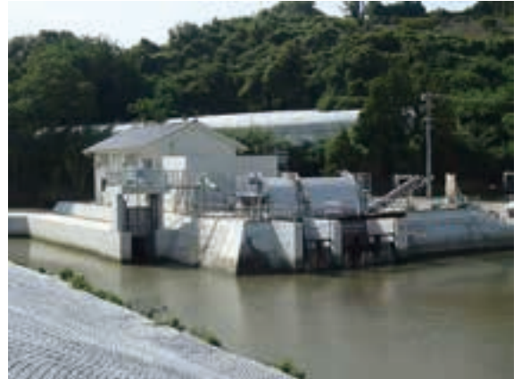
農業生産基盤整備(大口西部排水機場)
