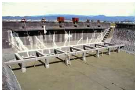
樋門の土砂堆積(豊川海岸)
