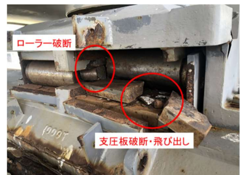
支承損傷状況
