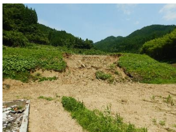
①農地の法面崩壊（山都町）
