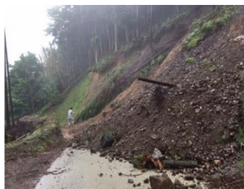
②林道の法面崩壊（美里町）
