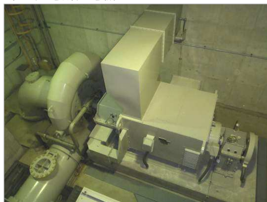
第三発電所発電機
