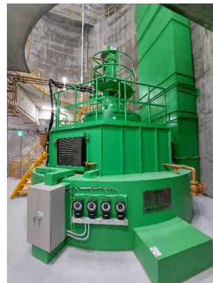
第二発電所発電機 (リニューアル後)
