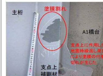
塗膜割れ状況
