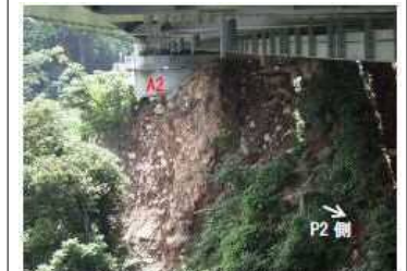
斜面崩壊状況
