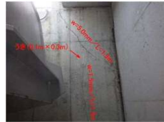
パラペット損傷状況
