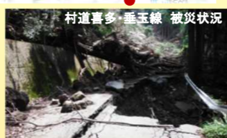
村道喜多・垂玉線 被災状況
