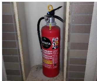
消火器の設置
