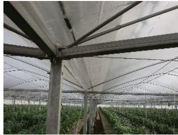
ハウスの内張り
