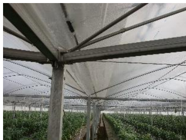
ハウスの内張り
