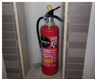
消火器の設置
