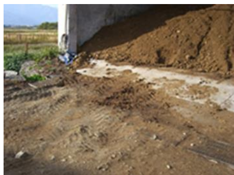
堆肥の散乱による汚染（×）
