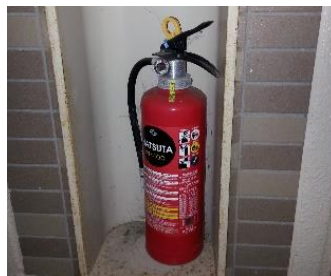
消火器の設置
