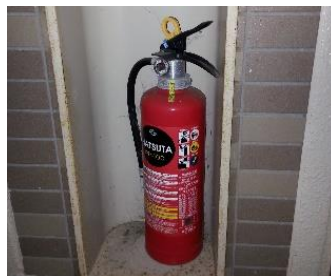
消火器の設置
