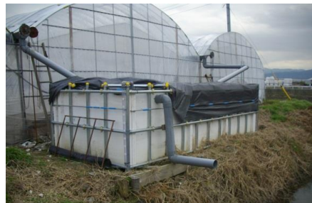
雨水利用を利用した施設園芸の灌水システム
