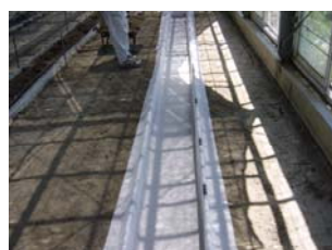
② 枠の内側に遮根シートを張り枠にパッカーで固定する
