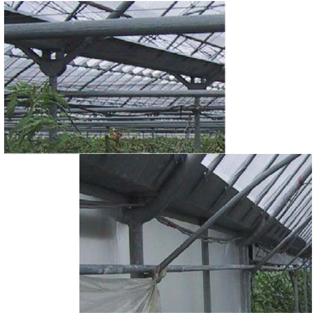
写真1 農家ハウス水平梁及び内張アーチの状況
