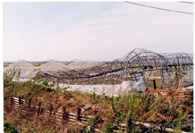
写真 1 サイド面からの倒壊
