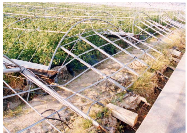
写真 2 妻面からの倒壊
