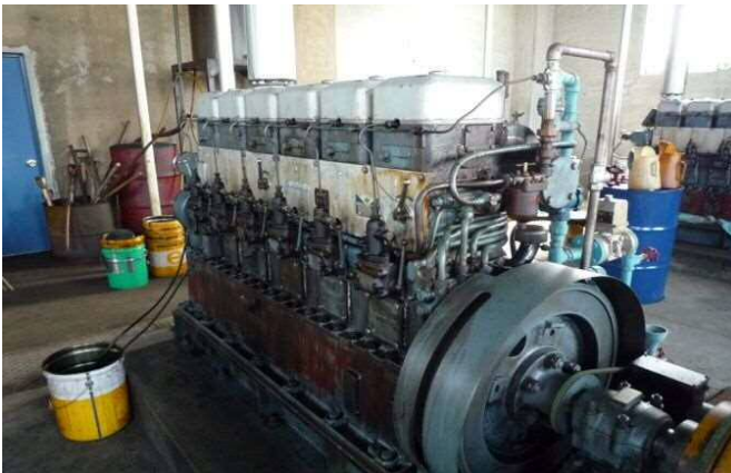
老朽化した排水機エンジン
