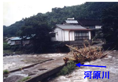
平成13年7月洪水による支川河原川第四藤田橋左岸側の被災状況
