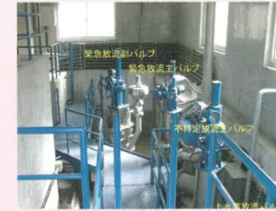
堤外バルブ室
