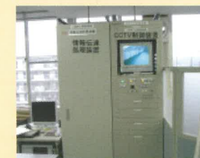
CCTV制御装置等
