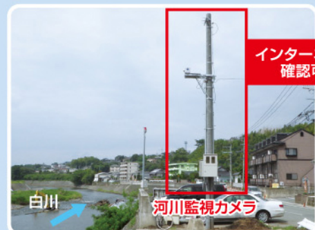
河川監視カメラ設置状況 (龍田町弓削)
