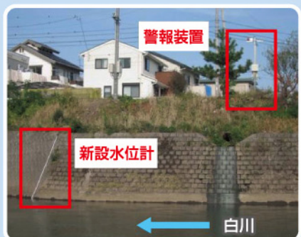
水位計と連動した警報装置設置状況 (龍田陳内4丁目)
