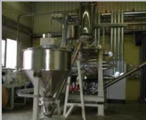
DELA 安定化工場
