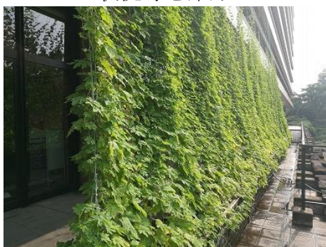
県庁のグリーンカーテンの設置状況
