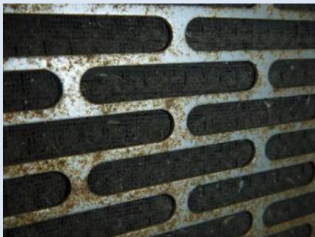
例) 吸入口の目詰まり状況
