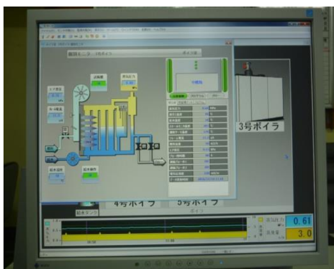
ボイラの常時監視モニター
