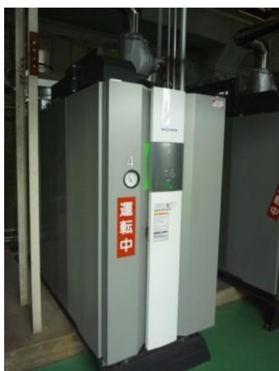
都市ガスボイラ
