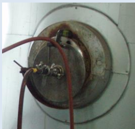
排ガス中酸素濃度を実測
