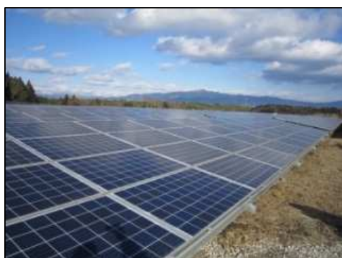
大規模太陽光発電所
