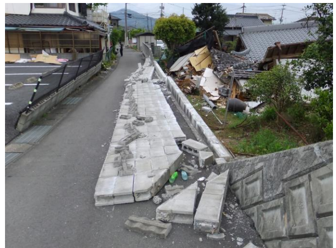
熊本地震により被災したブロック塀 の事例（益城町）
