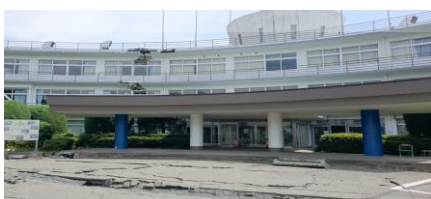
【東海大学阿蘇キャンパスの被災状況】 ※地震が建物にまで影響している
