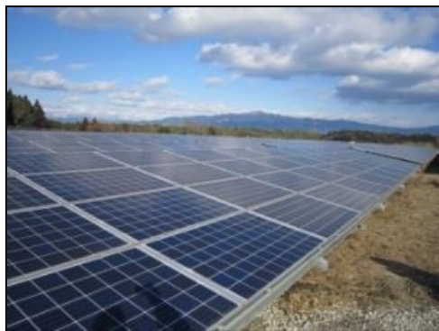
大規模太陽光発電所
