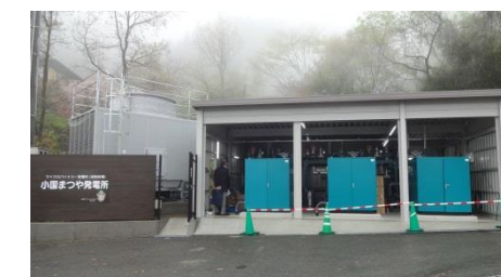
〔県内第1号の温泉熱発電所(小国まつや発電所)〕
