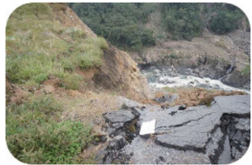
阿蘇大橋付近のがけ崩れの様子
