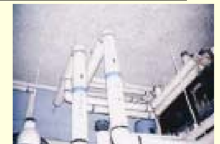
吸音・断熱材（機械室）
