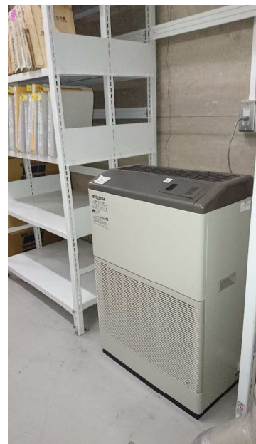
（写真） 【文書倉庫設置の除湿機】
