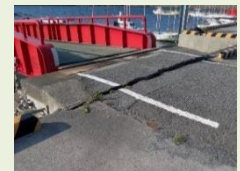
▲浮栈橋の損傷 （宇土市）
