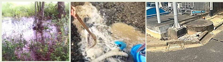
工業団地内（漏水） 八代市郡築（漏水） 白島浄水場（地盤沈下）
