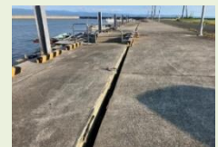
▲物揚場の傾倒・沈下 （宇城市）
