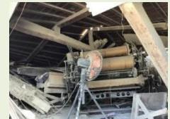
▲いぐさ製織作業場の倒壊 （八代市）
