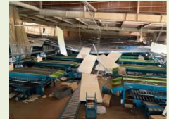
▲ＪＡ熊本経済連 第二園芸集送センターの損壊 （宇城市）
