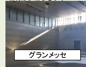
<被害状況写真>
