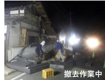
八代鏡宇土線（八代市） 倒壊建築物
